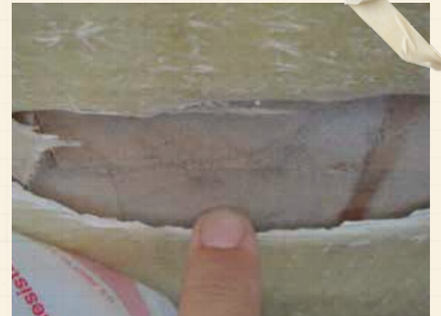
Расслоение корпуса из стекловолокна
